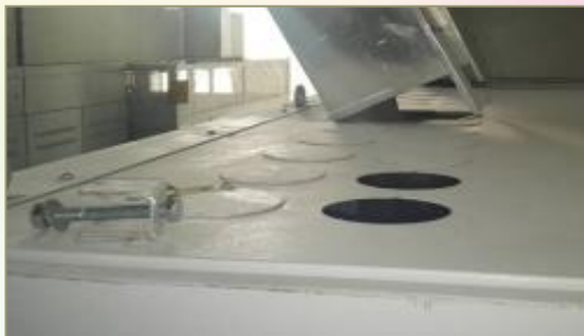
配电柜上方遗留杂物
