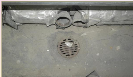
排水管偏离地漏
