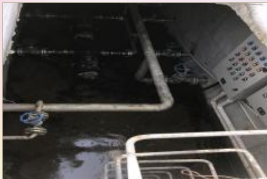
监控死角、缺少排水设施
