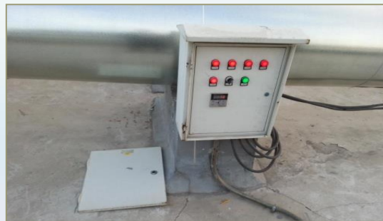
室外配电箱防护等级低
