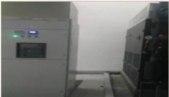
水源进入机房，无地漏
