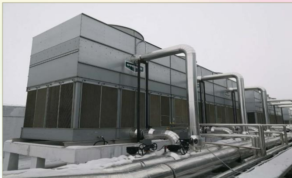
冷塔周边无检修马道
