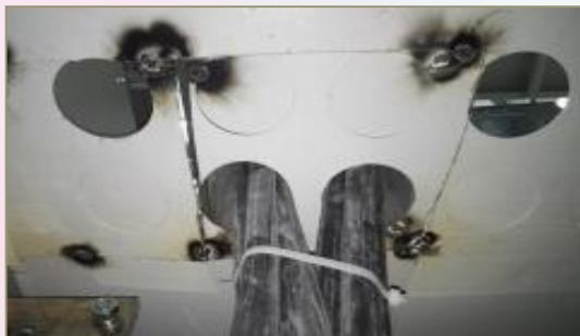
线缆护口缺失
