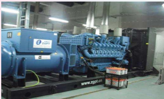
柴发室高压水喷雾在天花板上
